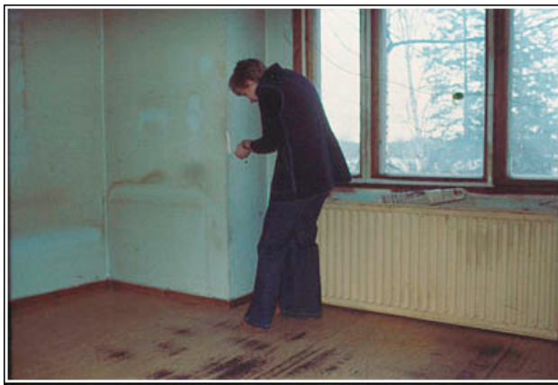
Remontti aloitettiin tulevasta keittiöstä. Se oli aiemmin ollut vanhan pariskunnan makuuhuone. Sängyn kuva näkyy vielä todisteena seinässä.
